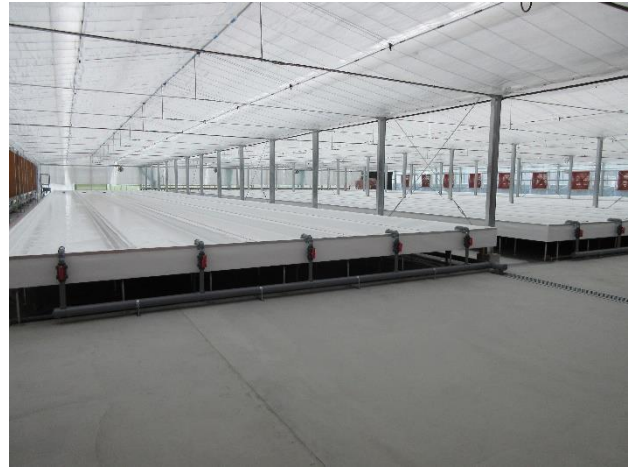
プラント室内
